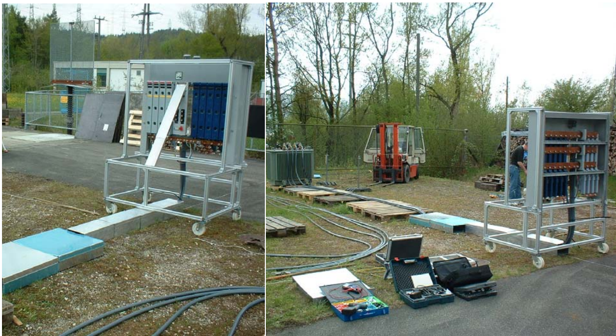
Figur 5.1: NS-Verteilung ohne Abschirmung Aussendimension der NS-Verteilung mit Rahmen 148×100×203 L×B×H in cm. Das Bodenniveau ist gleich Nullniveau (z=0)
